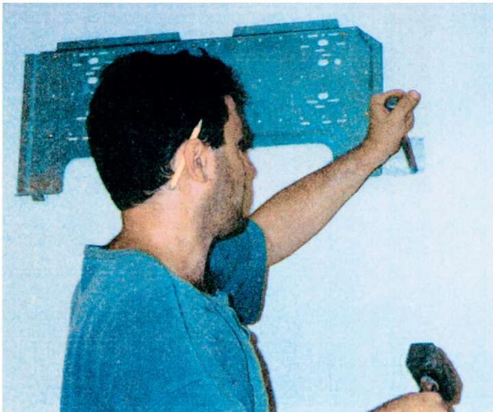
Εικόνα 6.2: Τοποθέτηση της μεταλλικής βάσης για το κρέμασμα της εσωτερική μονάδας. Άνοιγμα της τρύπας (δεξιά της βάσης, αφού η εσωτερική μονάδα έχει τις αναμονές των χαλκοσωλήνων στο δεξιό άκρο της) για τη σύνδεση με την εξωτερική μονάδα.
