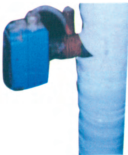
Σχήμα 1-14: Ελεγκτής ροής (flow switch) πάνω σε σωλήνα
